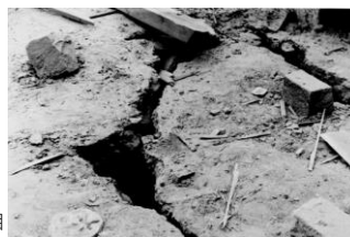
小学校の 床下に割目
